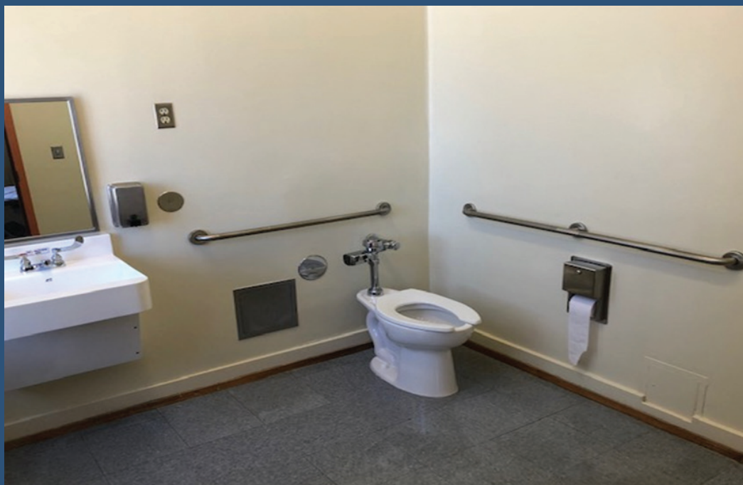
Baño en la Oficina de Enfermeras renovado para ser totalmente accesible.
